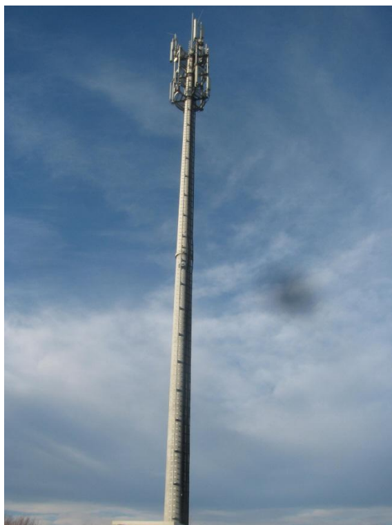
Zał. nr 1: Widok ogólny instalacji radiokomunikacyjnej.
