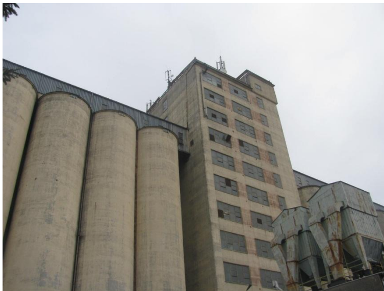
Zaf. nr 1: Widok ogólny instalacji radiokomunikacyjnej.
